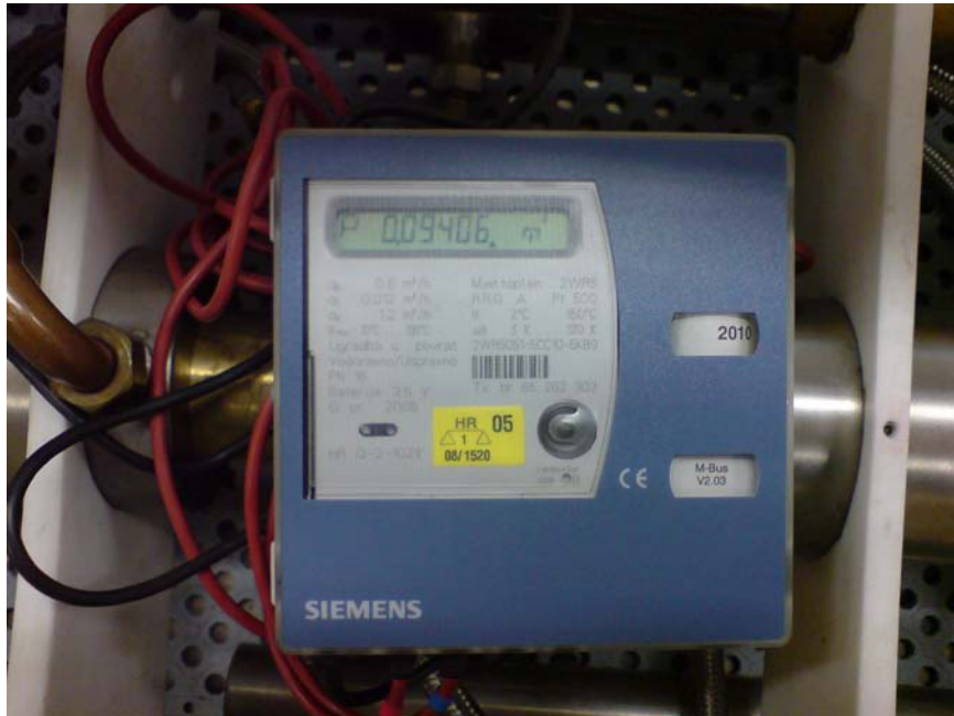
Slika 8.6 Kalorimetar SIEMENS 2WR5 u testnom modu
