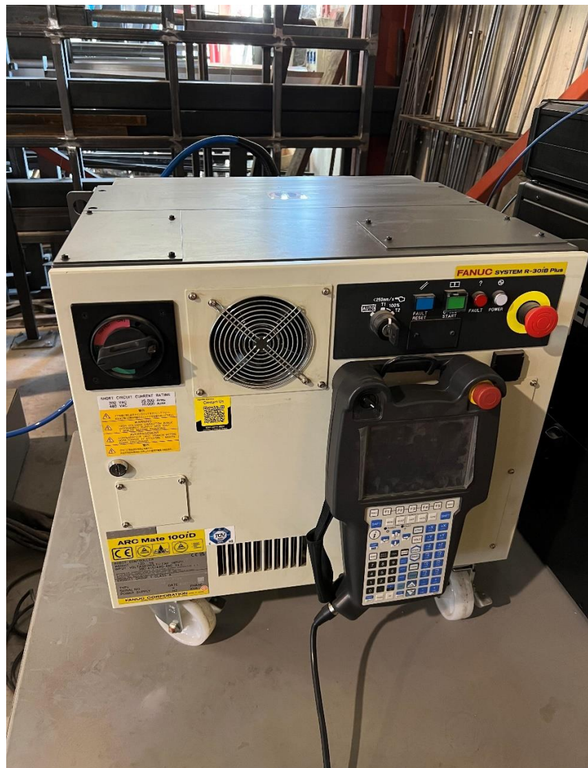
Slika 22. Upravljačka jedinica s kontrolerom
