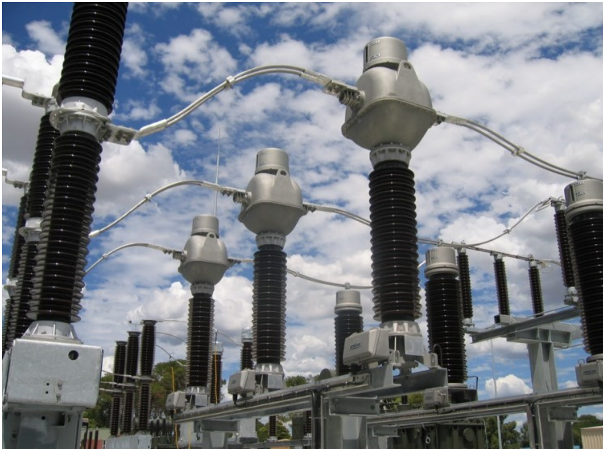
Slika 2.10 Strujni transformator – AGU [19]
