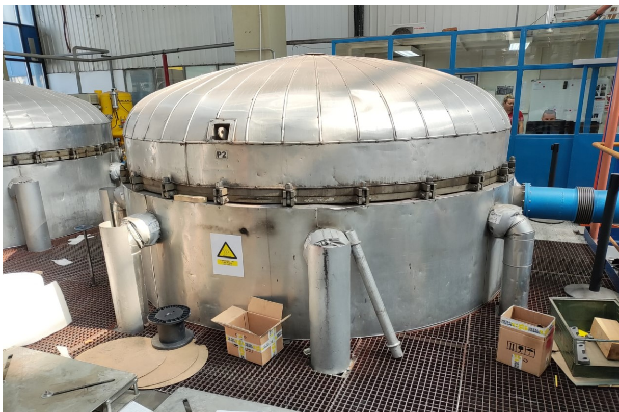
Slika 3.9 Peć za sušenje transformatora
