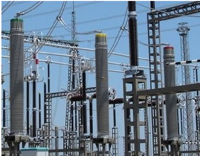
Slika 2.9 Visokonaponski mjerni transformator [19]
