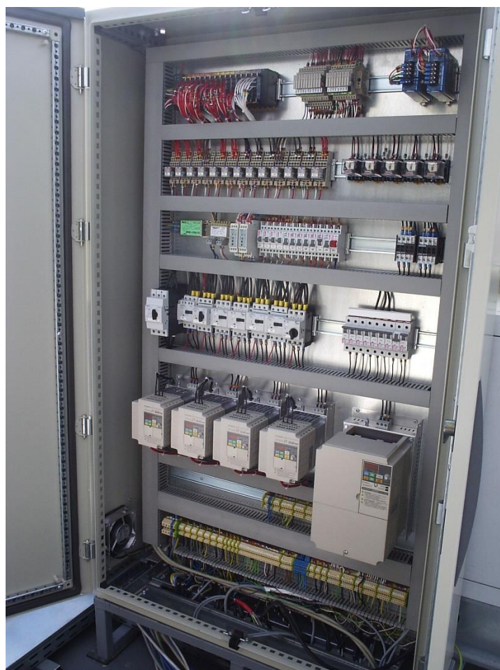
Slika 3. Prikaz ormara sa relejima korištenih za automatizaciju [3]
