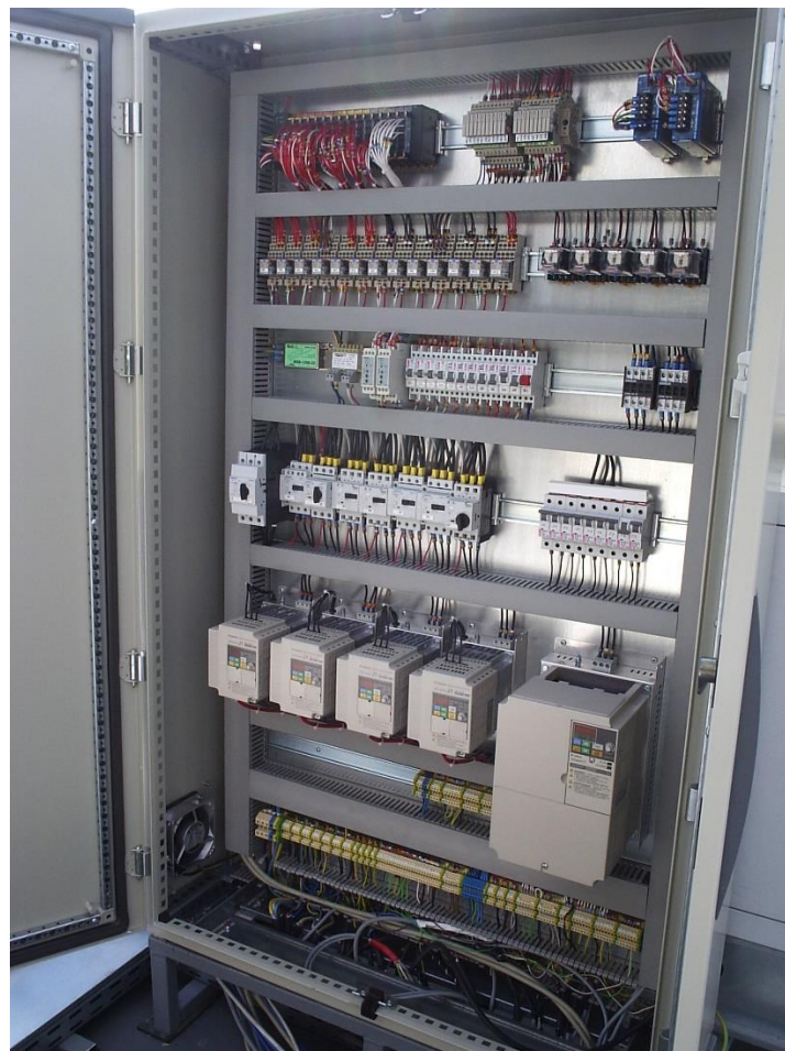
Slika 3. Prikaz ormara sa relejima korištenih za automatizaciju [3]
