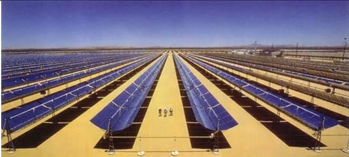
Slika 4. Solarno polje paraboličnih kolektora [6]
