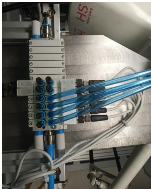
Slika 84. Prikaz instaliranog pneumatskog bloka s razvodnicima
