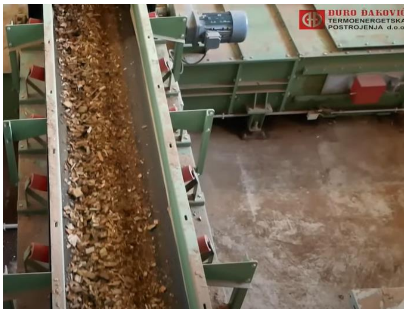
Slika 21. Konvejer za drvenu sječku u termoelektrani Brinje [16]
