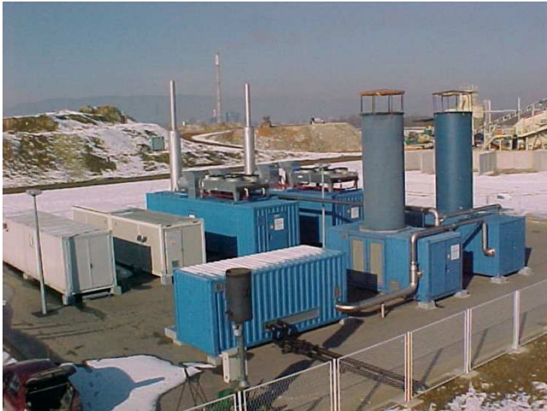
Slika 4.1. Plinsko postrojenje na Jakuševcu [10]
