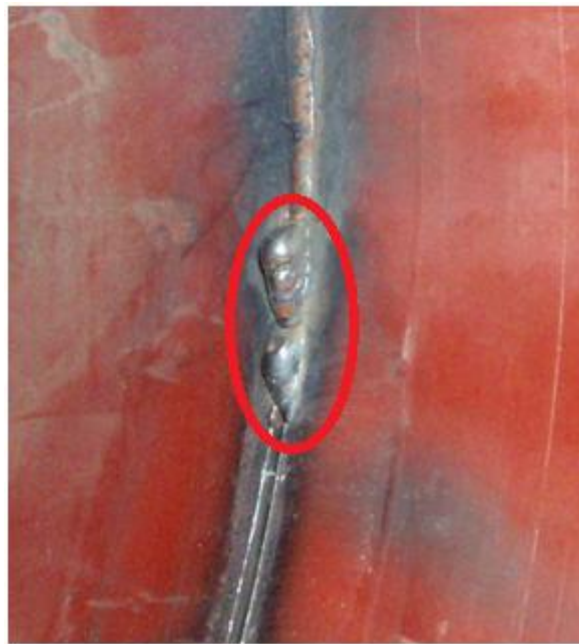
Slika 7.11 Korijen s unutarnje strane cijevi
