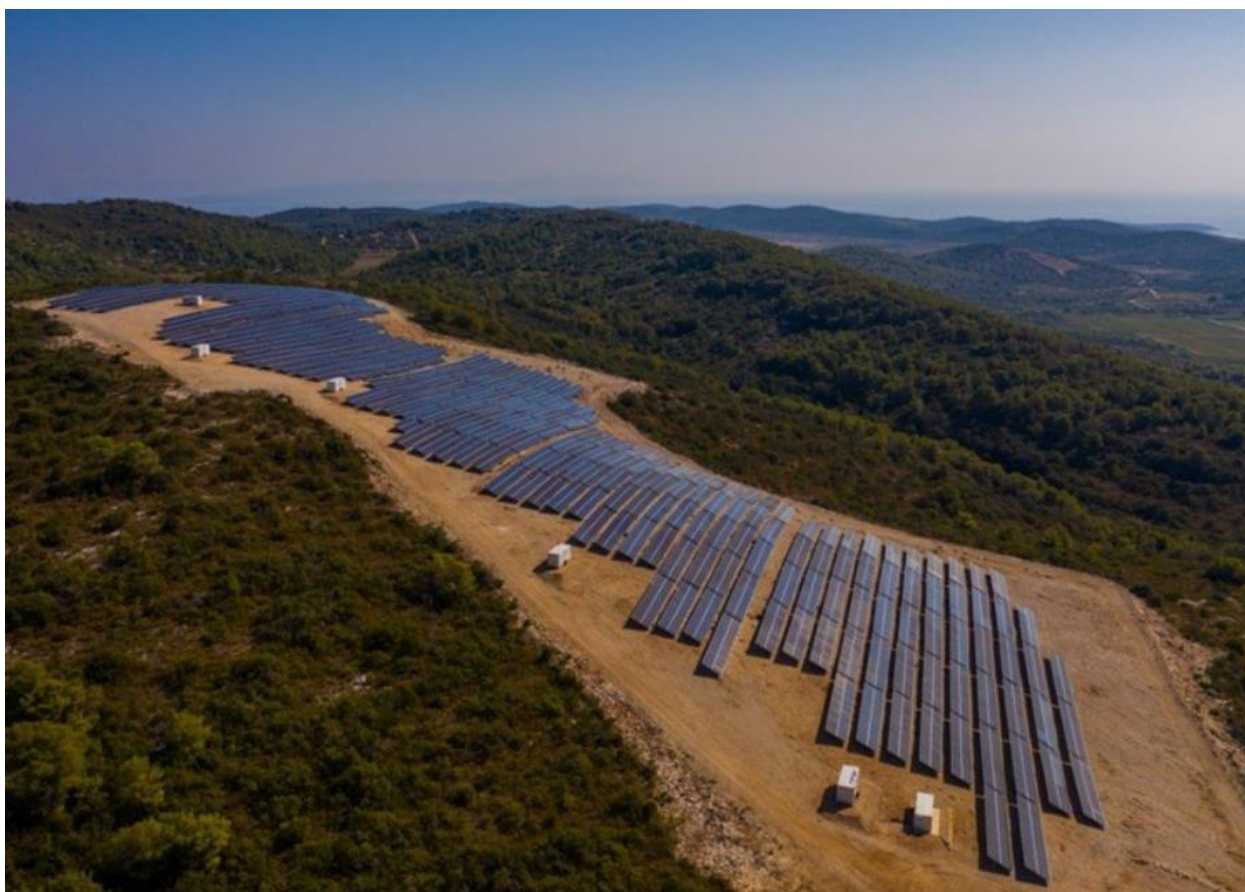
Slika 4 Solarna elektrana na Visu [5]
