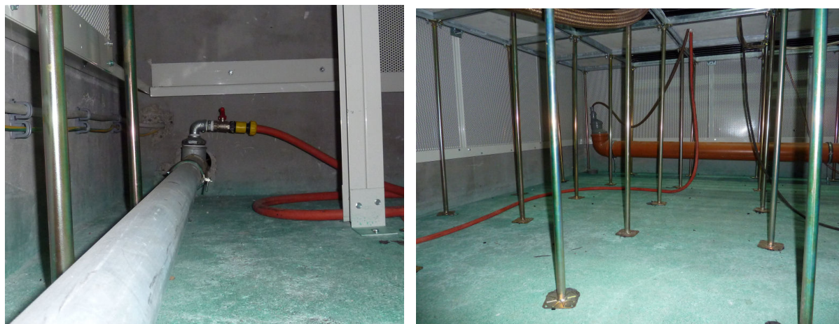
Slika 5.3 . Vodovodni priključak i kanalizacijski odvod u prostoru ispod poda laboratorija
