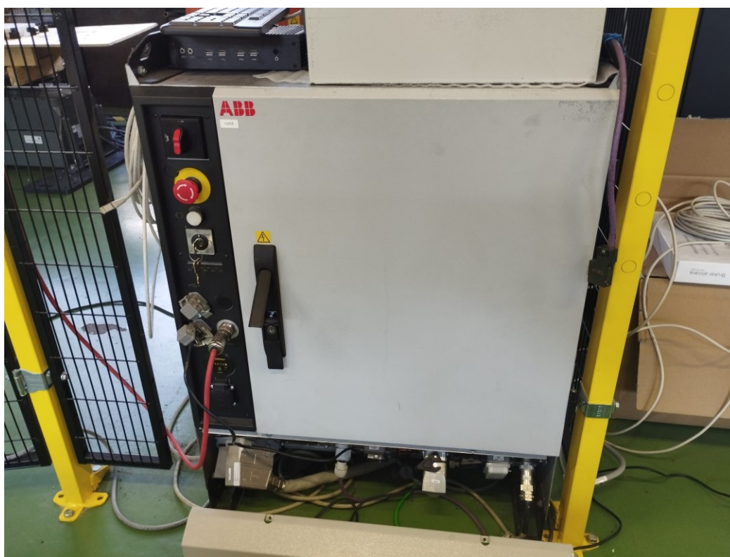
Slika 2. Upravljački sustav robota ABB IRB 6640-235/2.55
