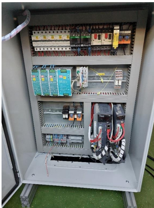
Slika 14. Temeljna ploča u upravljačkom ormaru
