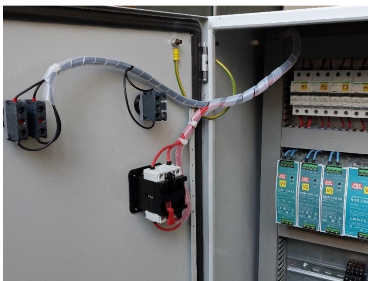
Slika 15. Zaštita ožičenja do sklopke i tipkala na vratima upravljačkog ormara
