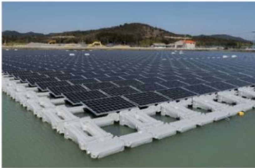
Slika 3.2 Primjer postavljenog FPV sustava iznad vode
