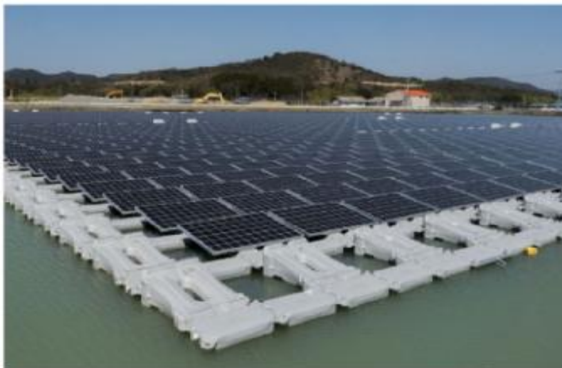
Slika 3.2 Primjer postavljenog FPV sustava iznad vode
