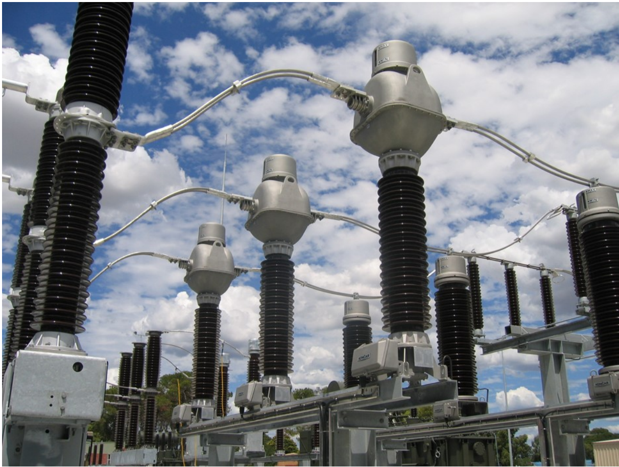
Slika 12. Mjerni transformator tipa AGU [7]
