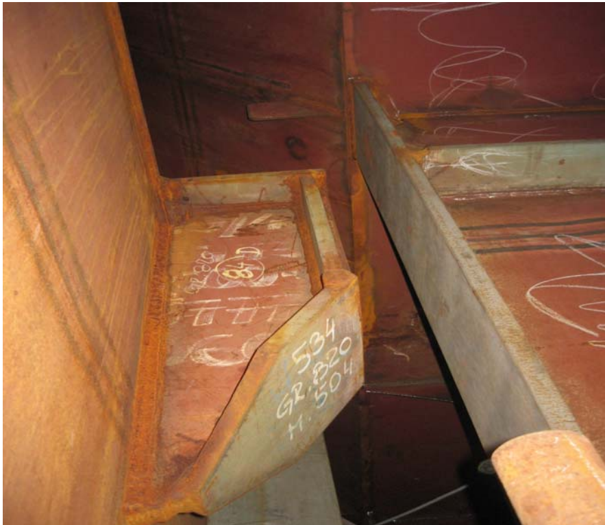
Slika 25 Dio protunaplavnog ključa montiran na vertikalnom boku tanka tereta
