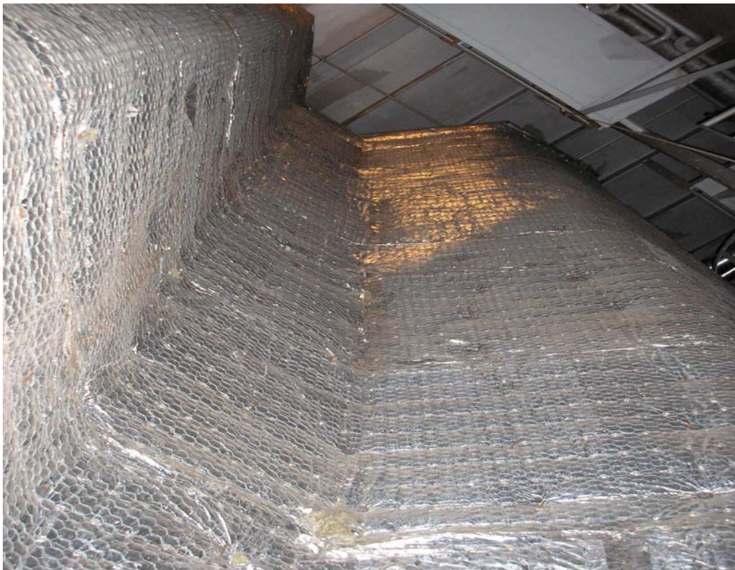
Slika 5 Izolacija tankova tereta
