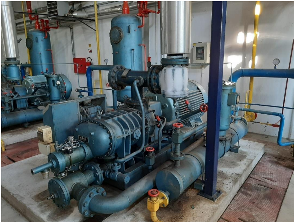
Slika 4 Vijčani kompresor direktnog rashladnog sustava
