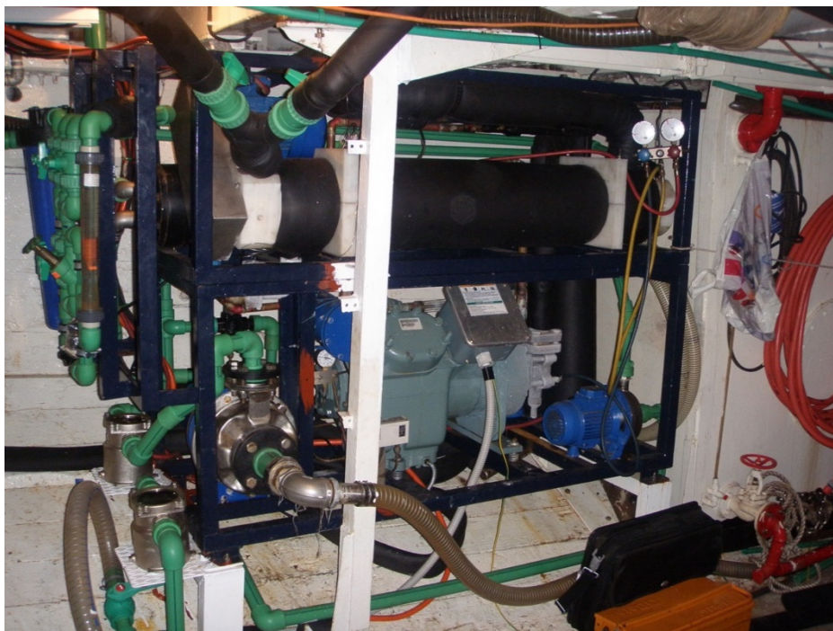
Slika 35. Kavezna izvedba sustava za proizvodnju leda montirana u strojarnicu broda [21]
