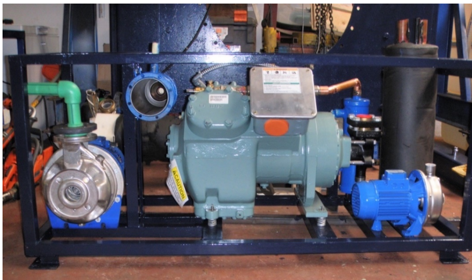
Slika 34. Kavezna izvedba sustava za proizvodnju leda u radionici [21]
