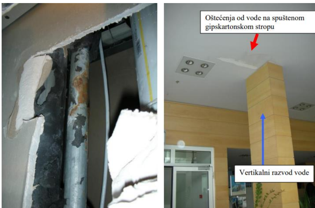
Slika 9. Prikaz oštećenja – propuštanje vode i oštećivanje objekta [10]
