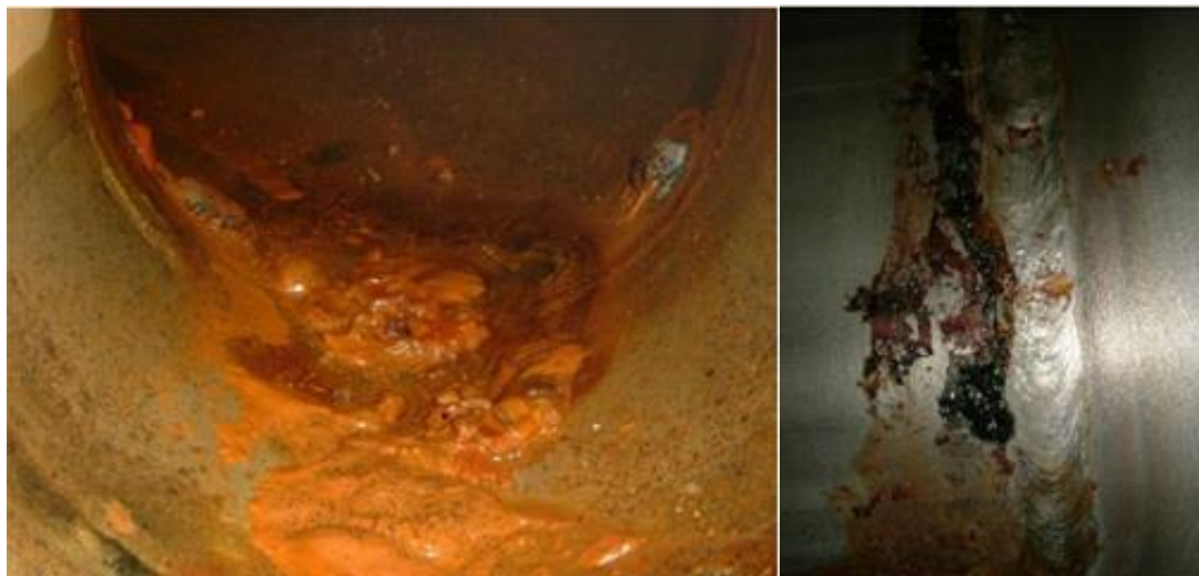
Slika 8. Nakupine u području zavarenih spojeva na unutarnjim stjenkama cjevovoda čelika AISI 304L (lijevo) i korozijski produkti i propuštanje vode na vanjskim stjenkama (desno) [10]
