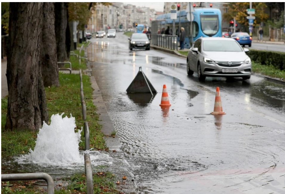
Slika 2. Posljedice puknuća cjevovoda [6]
