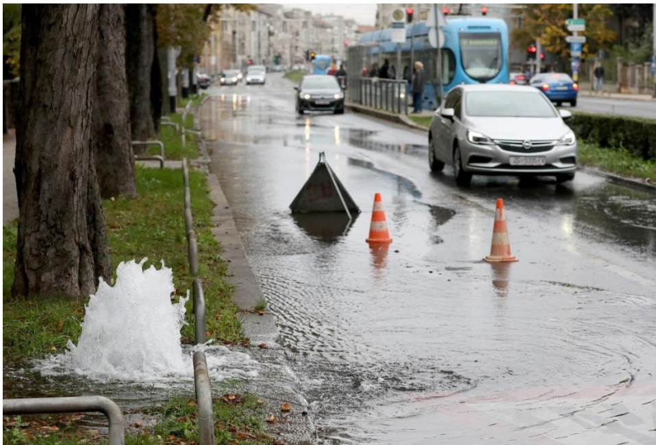
Slika 2. Posljedice puknuća cjevovoda [6]
