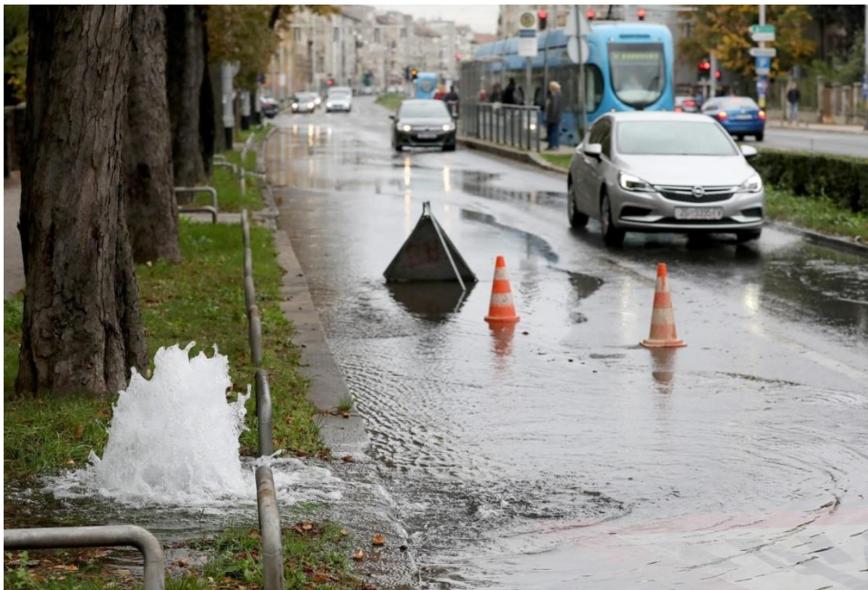
Slika 2. Posljedice puknuća cjevovoda [6]
