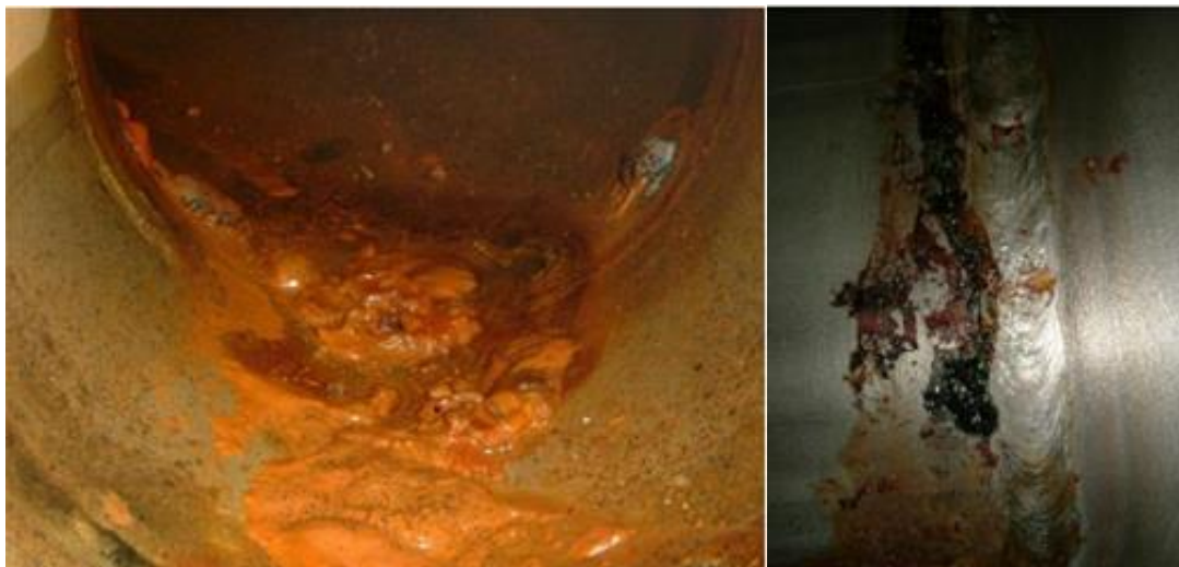
Slika 8. Nakupine u području zavarenih spojeva na unutarnjim stjenkama cjevovoda čelika AISI 304L (lijevo) i korozijski produkti i propuštanje vode na vanjskim stjenkama (desno) [10]
