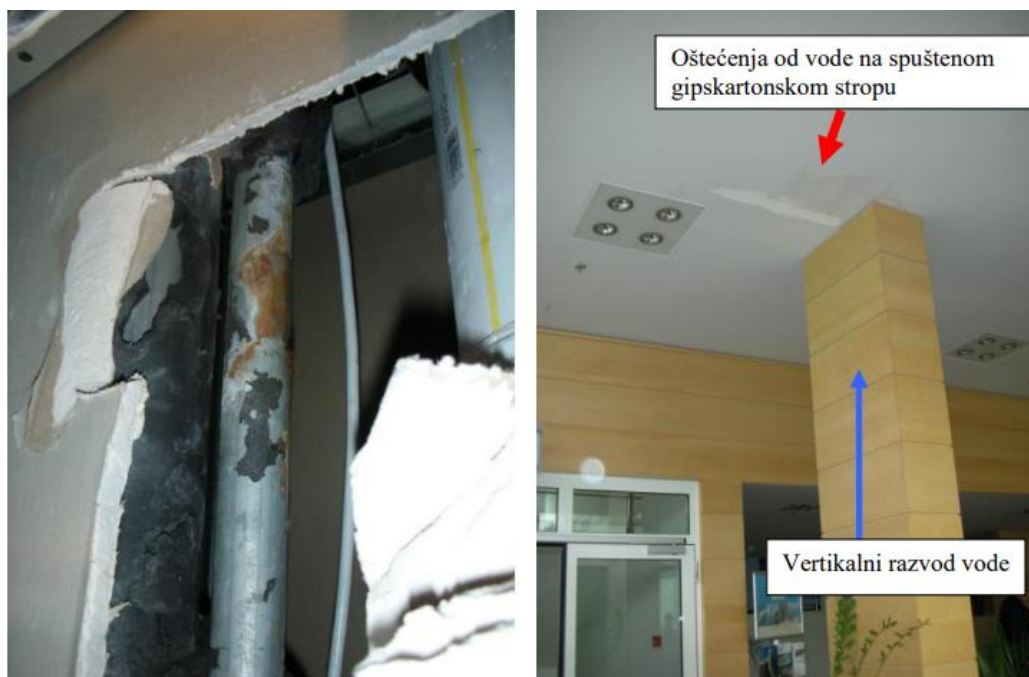
Slika 9. Prikaz oštećenja – propuštanje vode i oštećivanje objekta [10]
