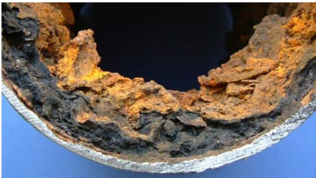
Slika 6. Korozijski produkti unutar cjevovoda tehnološke vode [10]
