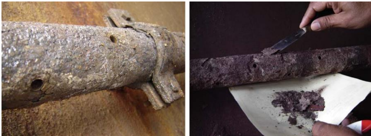
Slika 18. Korozija parne cijevi
