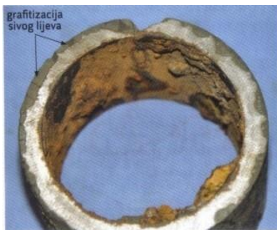
Slika 4. Selektivna korozija sivog lijeva [3]
