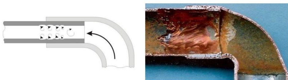
Slika 7. Djelovanje erozijske korozije na materijal [3]
