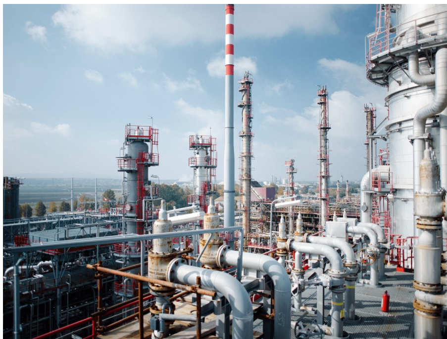
Slika 2. Primjer procesnog postrojenja – naftna rafinerija [5]
