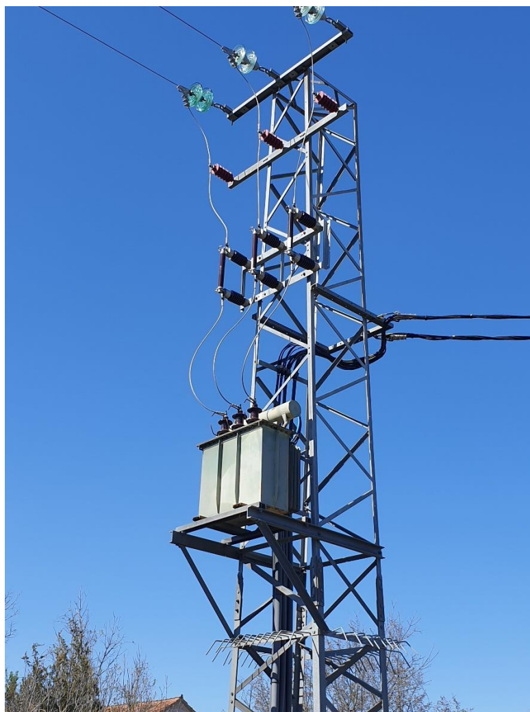
Slika 7: Fotografija distributivnog transformatora
