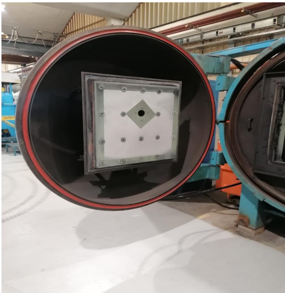
Slika 22. Vidljiva propuštanja na starijoj vakuumskoj peći u Centru toplinske obrade d.o.o.
