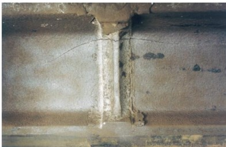
Slika 9. Primjer pukotine označene kodom 422 [13]
