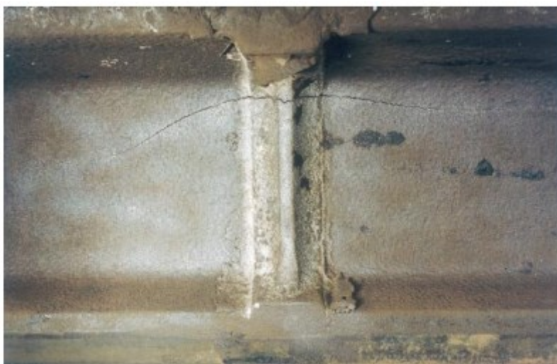
Slika 9. Primjer pukotine označene kodom 422 [13]
