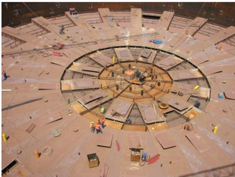
Slika 1. Plutajući krov, Terminal Sisak
