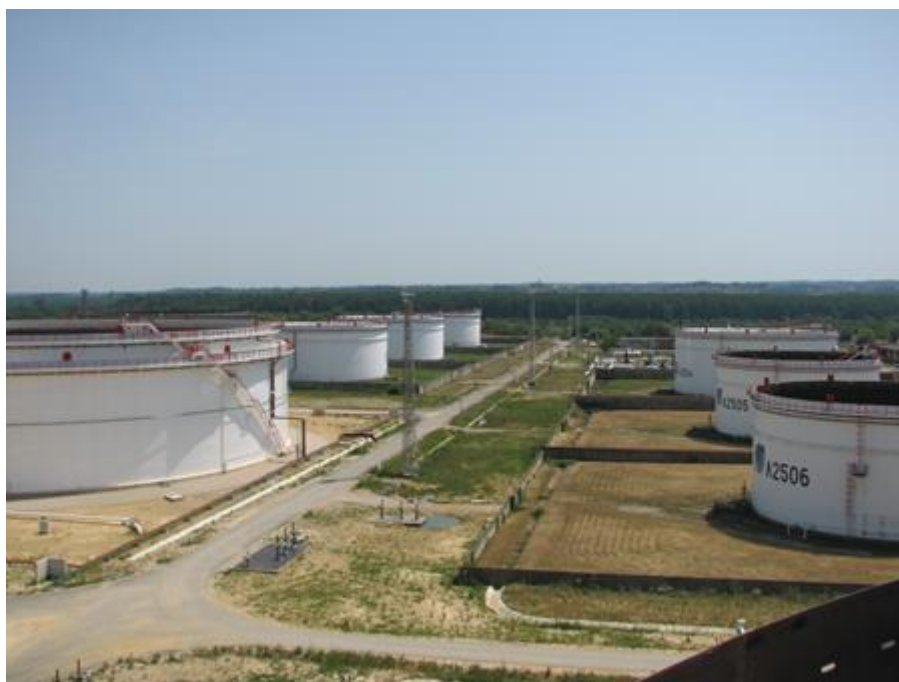
Slika 6. Prikaz spremnika zaštićenih premazima, Terminal Sisak
