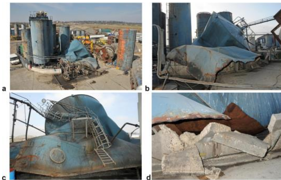
Slika 4. Havarija spremnika uzrokovana unutarnjom korozijom [12]
