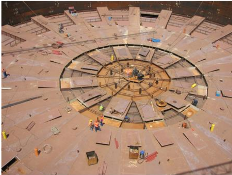
Slika 1. Plutajući krov, Terminal Sisak
