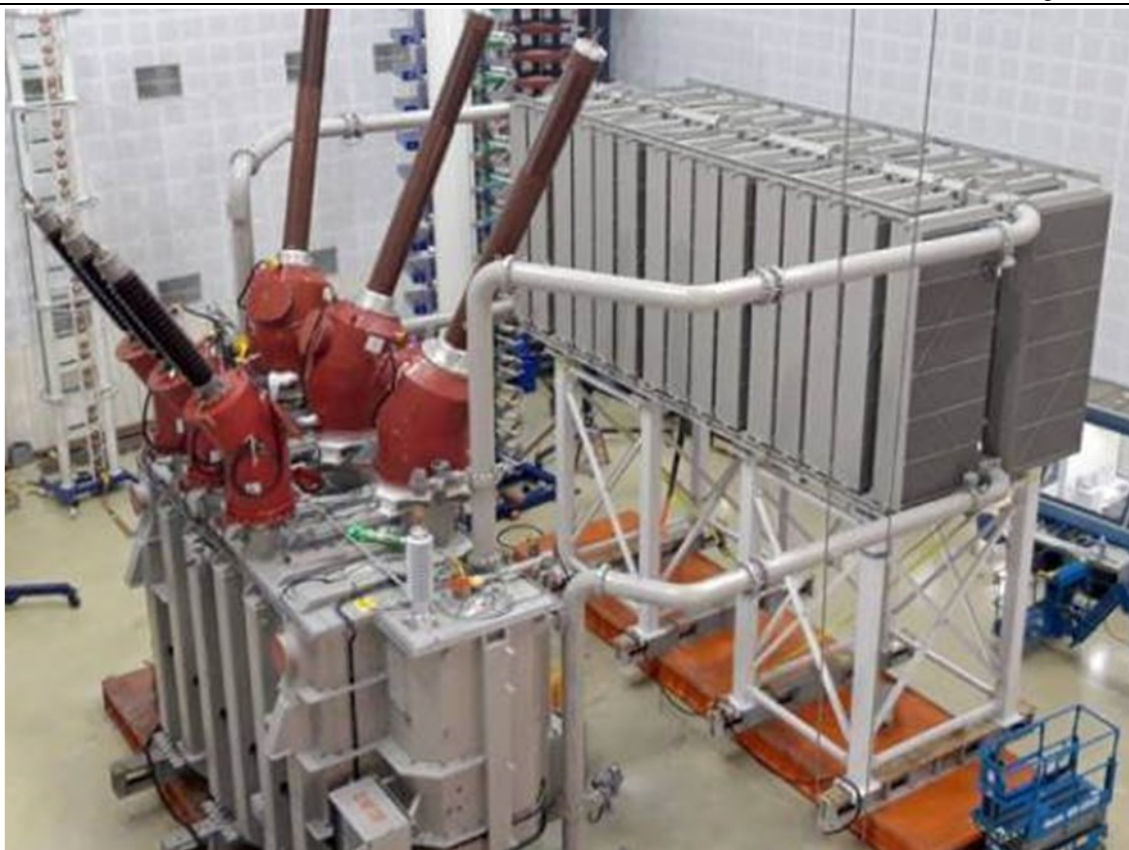
Slika 2.13 Odvojeni sustav za hlađenje transformatora 9 [12]
