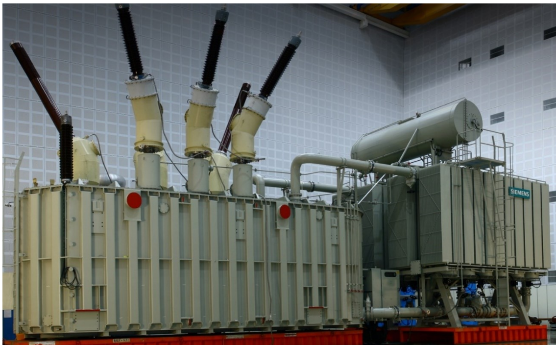
Slika 2.8 Odvojeni sustav za hlađenje transformatora 4 [7]
