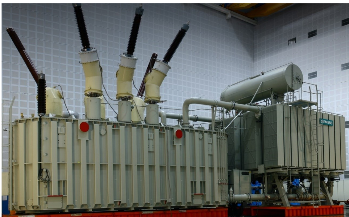
Slika 2.8 Odvojeni sustav za hlađenje transformatora 4 [7]
