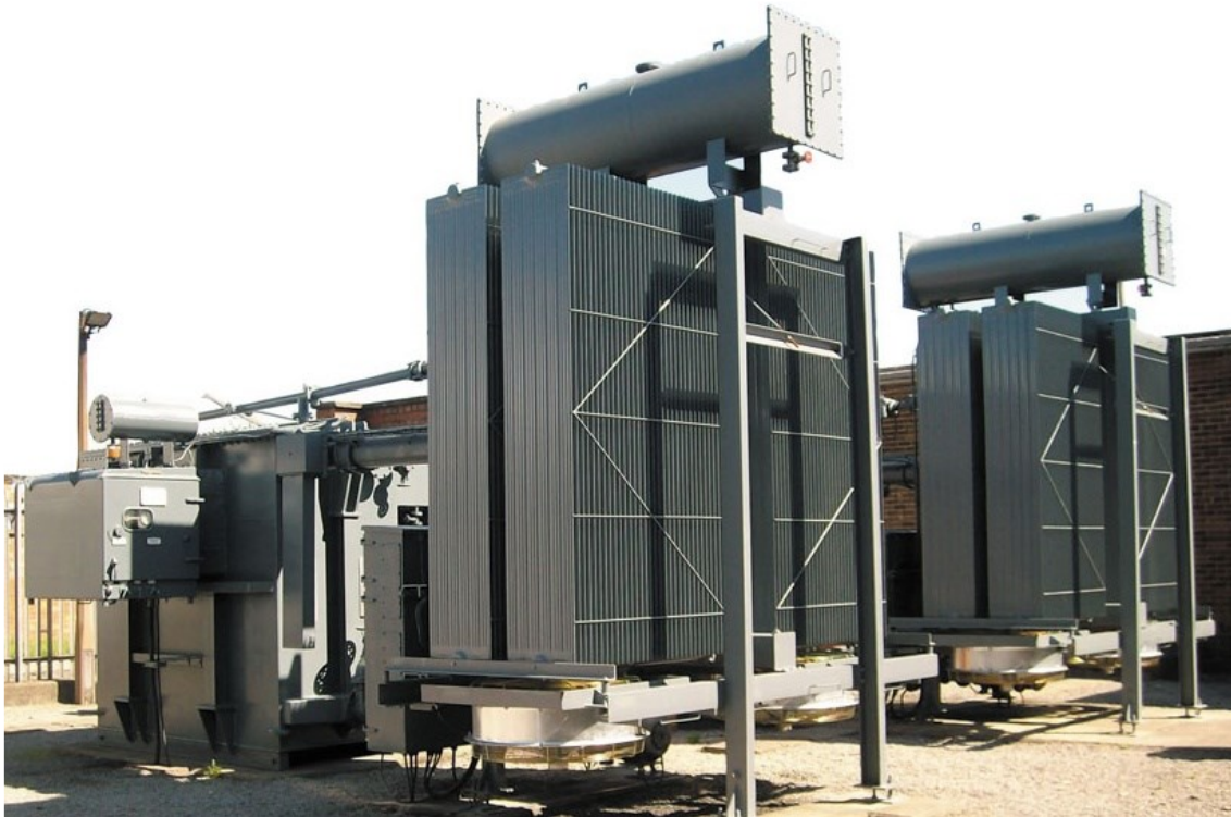
Slika 2.7 Odvojeni sustav za hlađenje transformatora 3 [6]
