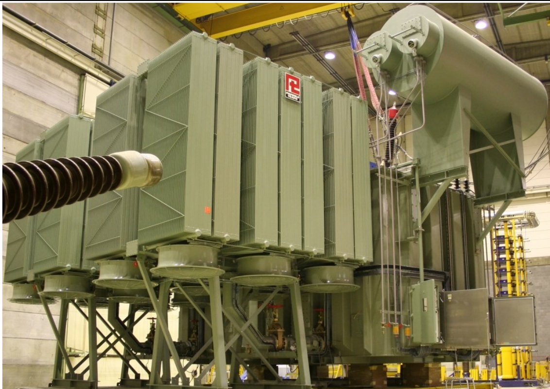
Slika 2.9 Odvojeni sustav za hlađenje transformatora 5 [8]
