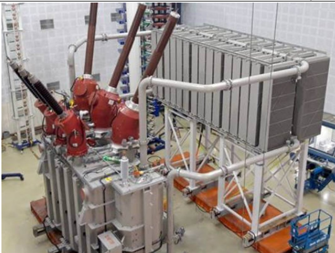
Slika 2.13 Odvojeni sustav za hlađenje transformatora 9 [12]
