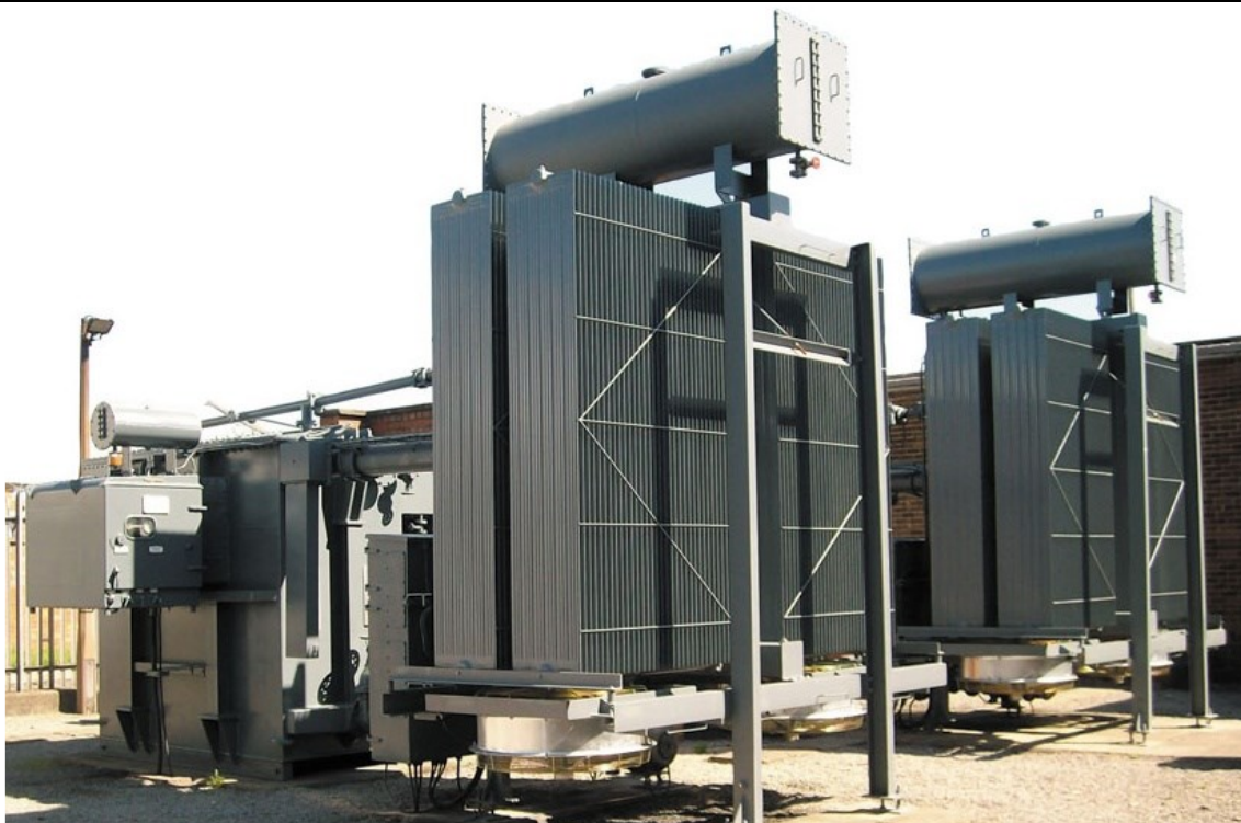
Slika 2.7 Odvojeni sustav za hlađenje transformatora 3 [6]
