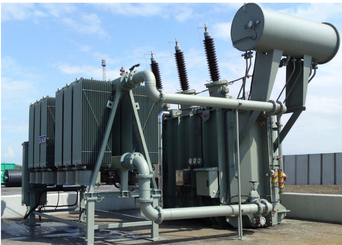
Slika 2.10 Odvojeni sustav za hlađenje transformatora 6 [9]
