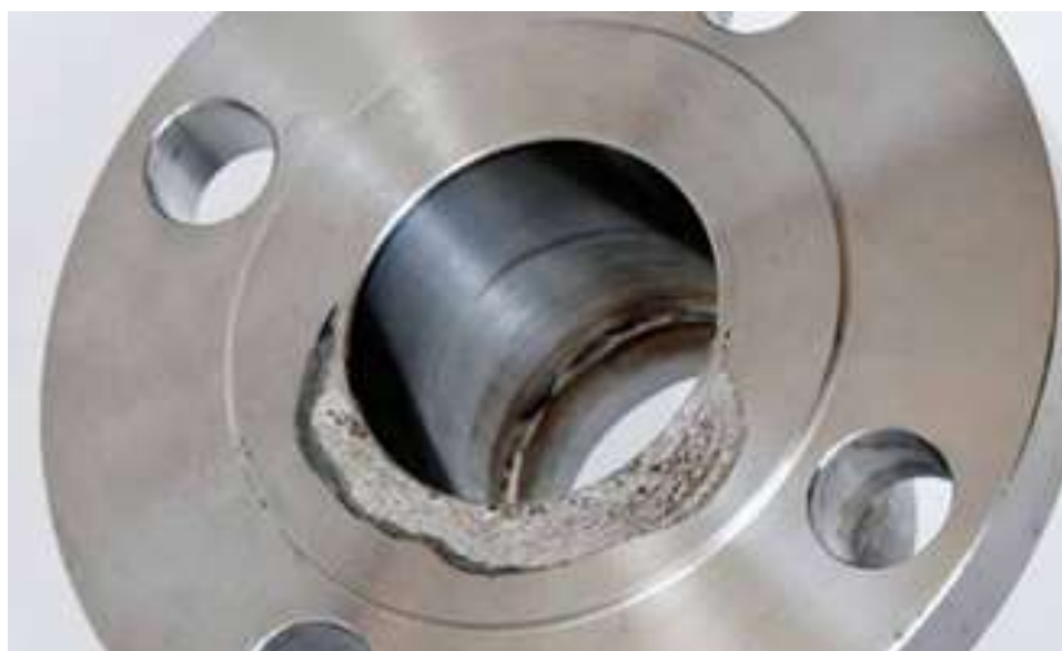
Slika 26. Korozija u procijepu ispod brtve na prirubnici izloženoj kloriranoj morskoj vodi [1].
