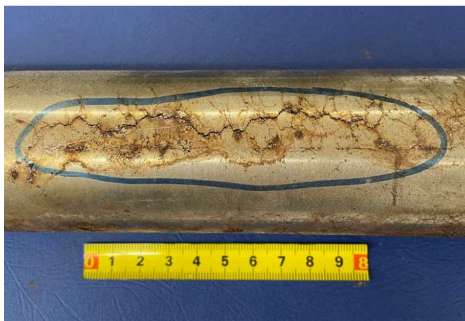
Slika 53. Otvorena pukotina na vanjskoj površini cijevi.
