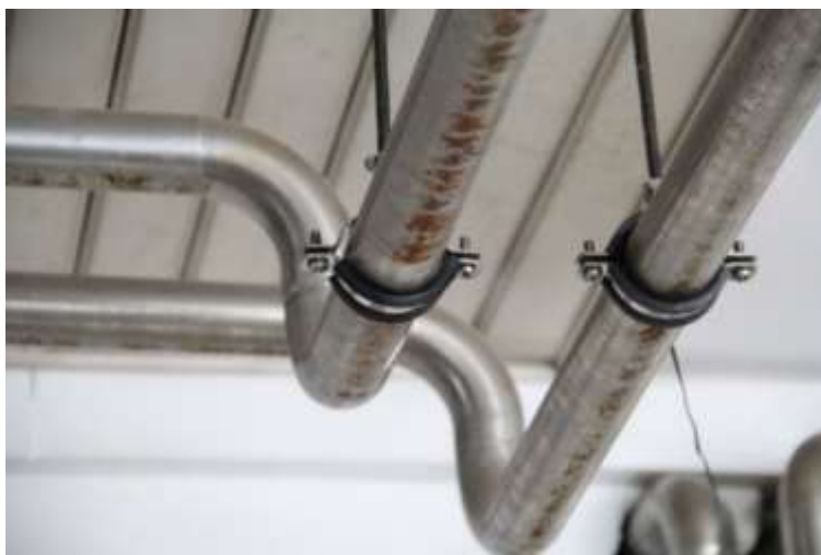
Slika 46. Korozijsko oštećenje segmenta cjevovoda pogona za preradu mlijeka.
