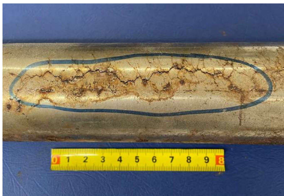
Slika 53. Otvorena pukotina na vanjskoj površini cijevi.
