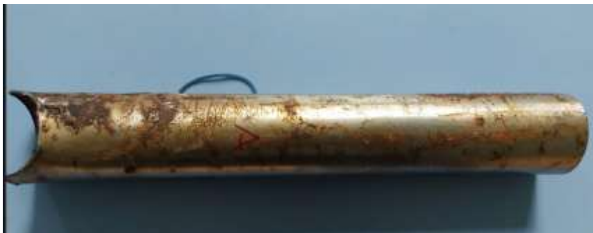
Slika 49. Segment A izrezan sa konstrukcije.
