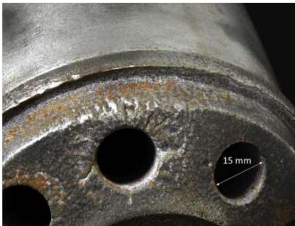
Slika 30. Površinska interkristalna korozija nastala zbog senzibilizacije [18].
