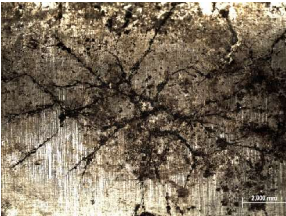
Slika 59. Pukotine na vanjskoj površini cijevi.
