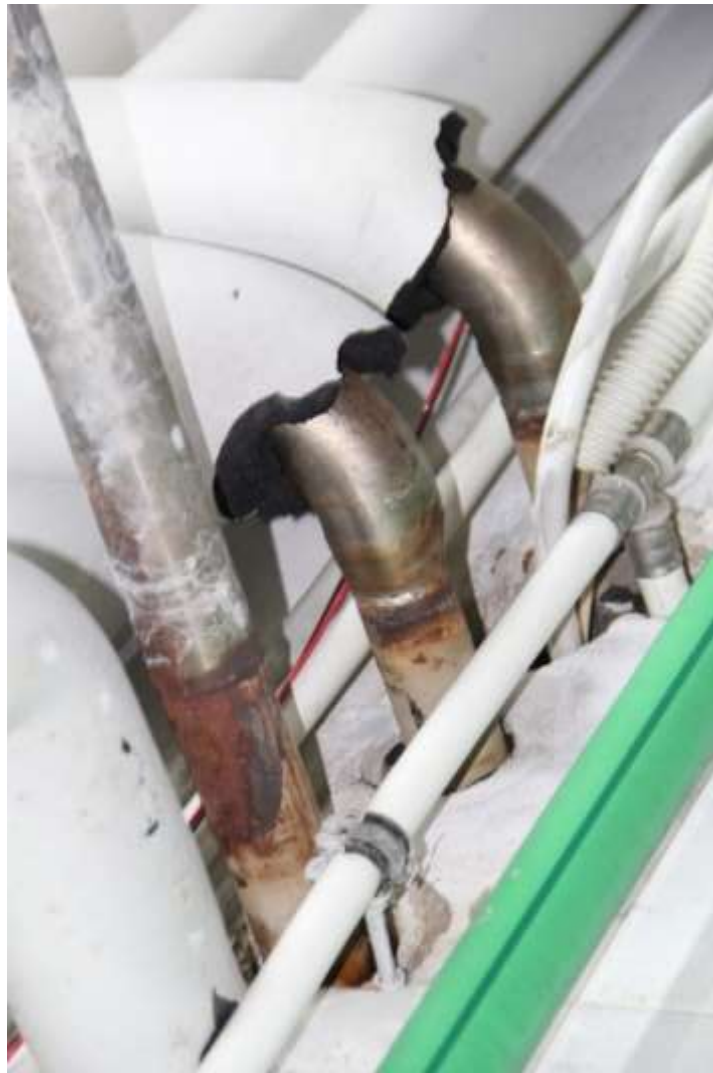
Slika 47. Korozijsko oštećenje ispod obloga cjevovoda pogona za preradu mlijeka.
