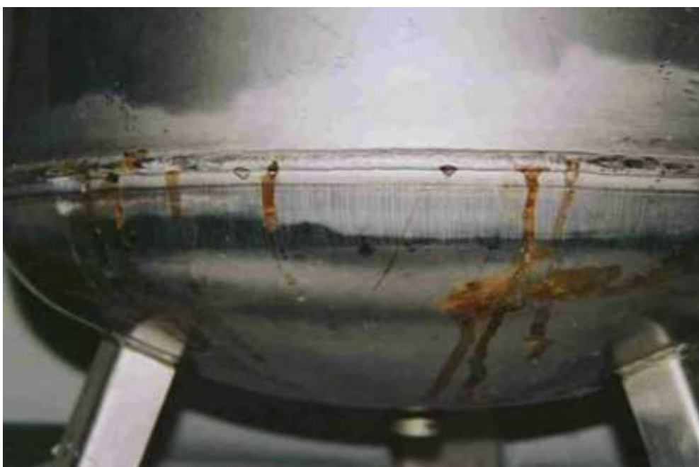
Slika 28. Korozija u procijepu preklopnog zavarenog spoja [18].
