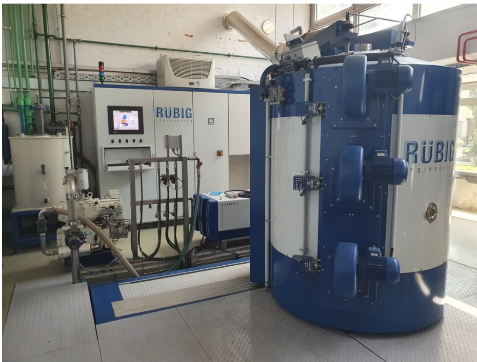
Slika 7.4. Postrojenje za PACVD postupak
