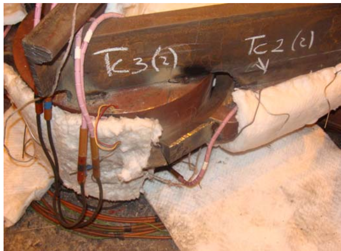
Slika 10. Dio opreme za elektrootporno predgrijavanje, Brodogradilište Uljanik, Pula
