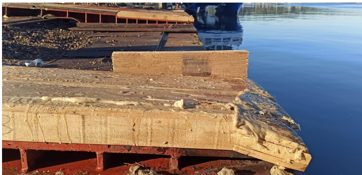
Slika 35. Prikaz oštećenja drvene podloge.
