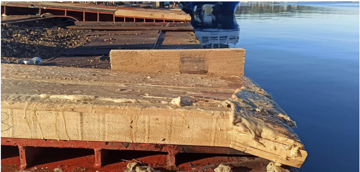
Slika 35. Prikaz oštećenja drvene podloge.
