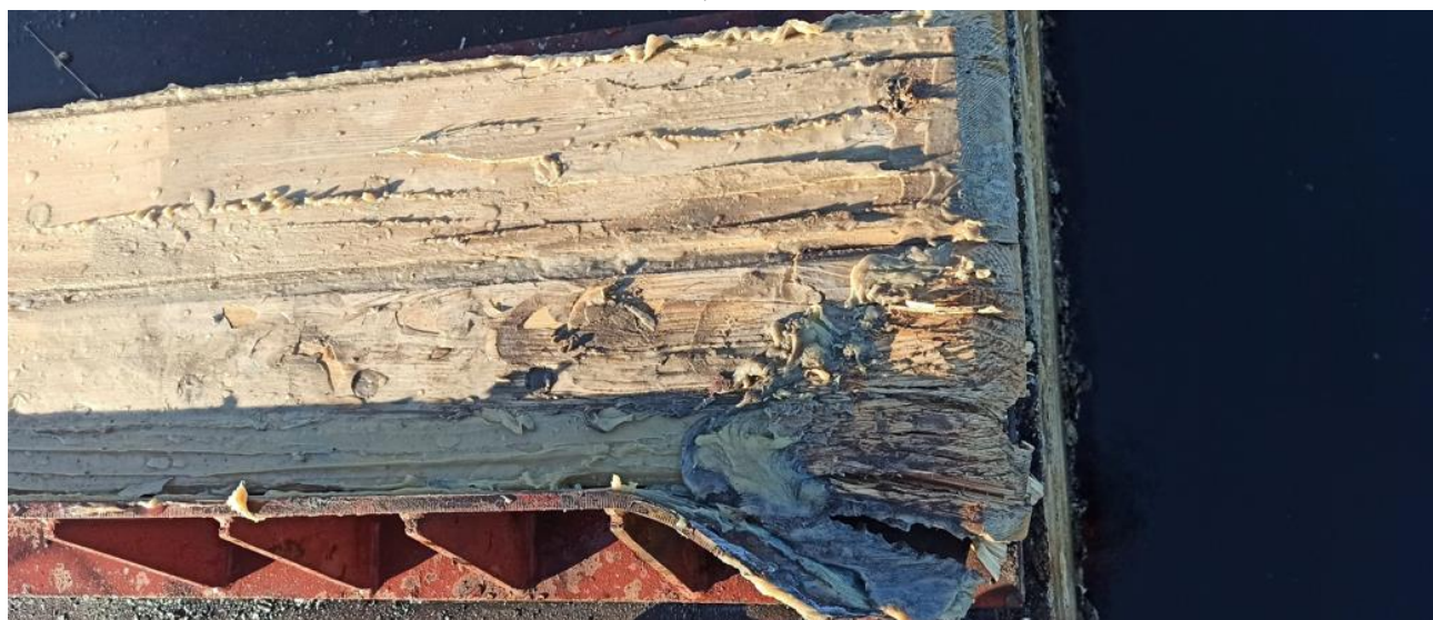
Slika 36. Prikaz oštećenja drvene podloge.
