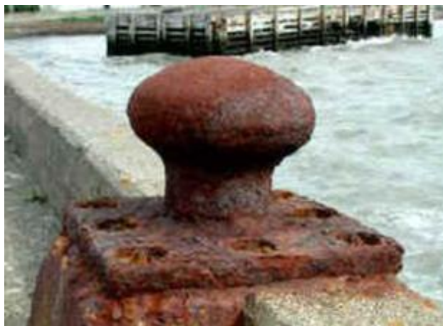
Slika 14. Opća korozija stupa za vez broda [22]
