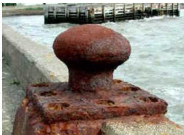
Slika 14. Opća korozija stupa za vez broda [22]
