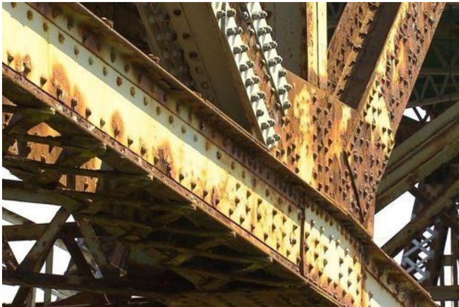
Slika 14. Atmosferska korozija čelične konstrukcije mosta [16]
