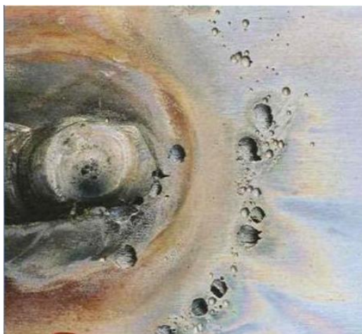
Slika 5. Primjer rupičaste korozije [10]
