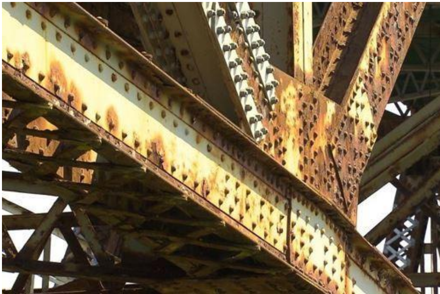
Slika 14. Atmosferska korozija čelične konstrukcije mosta [16]
