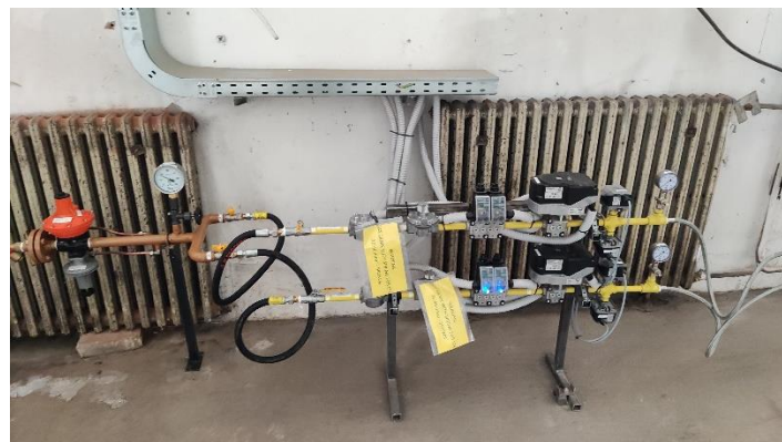
Slika 20. Sustav za dovod plina u tvrtki Končar – Metalne konstrukcije
