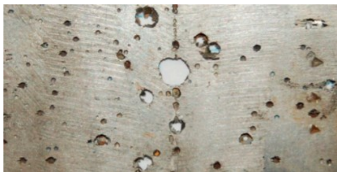
Slika 6. Točkasta korozija čelika [13]
