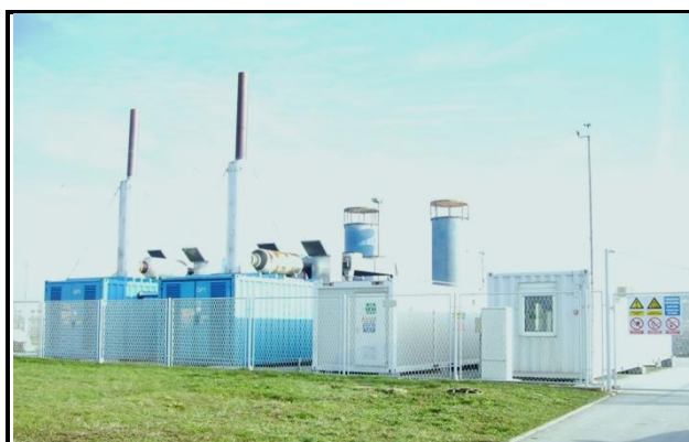
Slika 8. Postrojenje za obradu deponijskog plina na odlagalištu otpada Jakuševac
