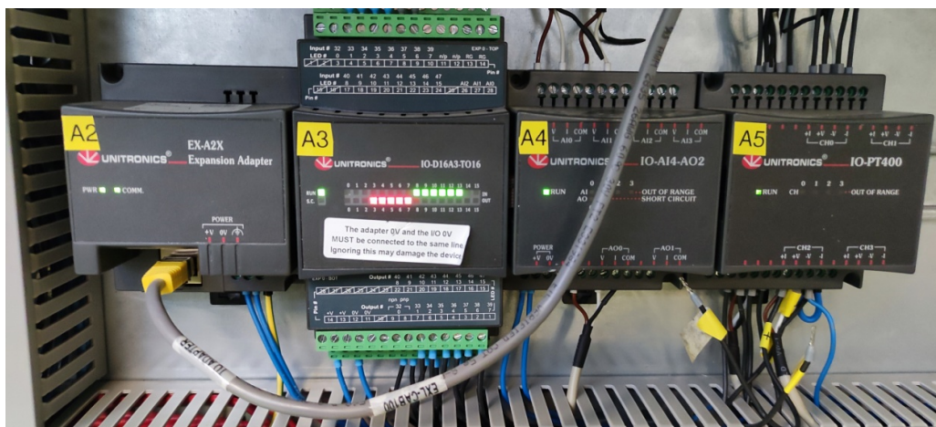
Slika 14. Ekspanzijski moduli PLC uređaja
