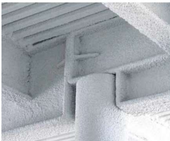
Slika 9. Protupožarna zaštita cementnim sustavom [19]
