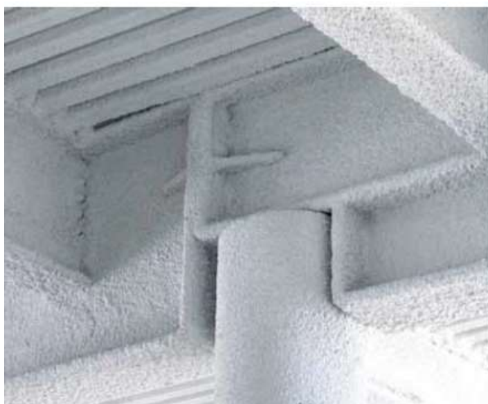
Slika 9. Protupožarna zaštita cementnim sustavom [19]
