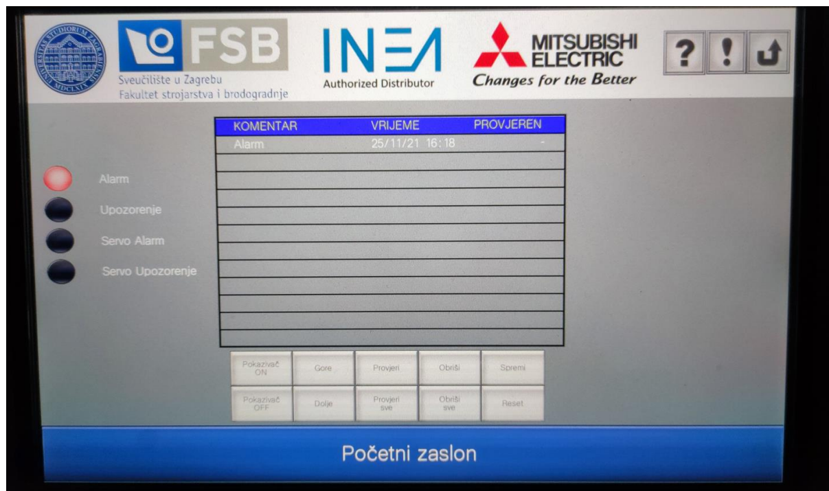
Slika 68. Ispis alarma u tablici praćenja alarma na HMI-u
