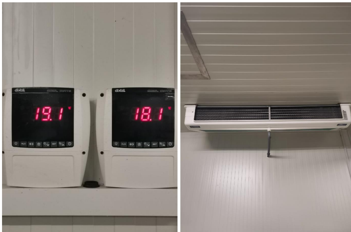
Slika 14. Rashladni uređaj i kontroler u vinariji Jagunić
