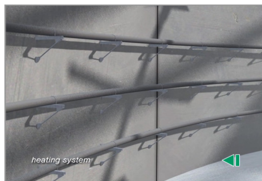
Slika 2.24. Cijevi za grijanje instalirane u fermentator
