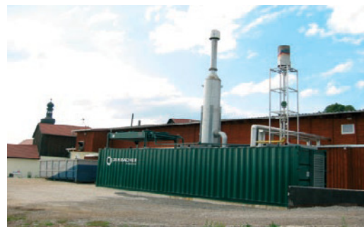
Slika 5.4. Vanjska ugradnja kogeneracijske jedinice
