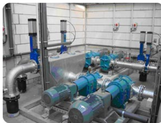
Slika 2.20. Sustav za pumpanje
