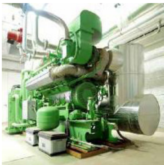
Slika 2.11. Kogeneracijska jedinica za proizvodnju električne energije
