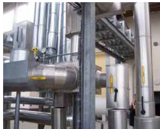
Slika 2.26. Izolirane cijevi za plin
