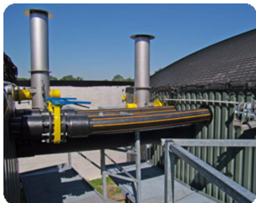
Slika 2.25. Sigurnosni ventil na plinovodu
