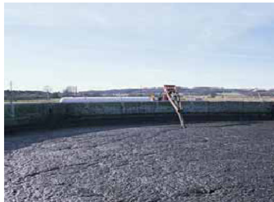
Slika 2.35. Spremnik za skladištenje digestata
