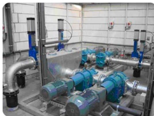
Slika 2.20. Sustav za pumpanje
